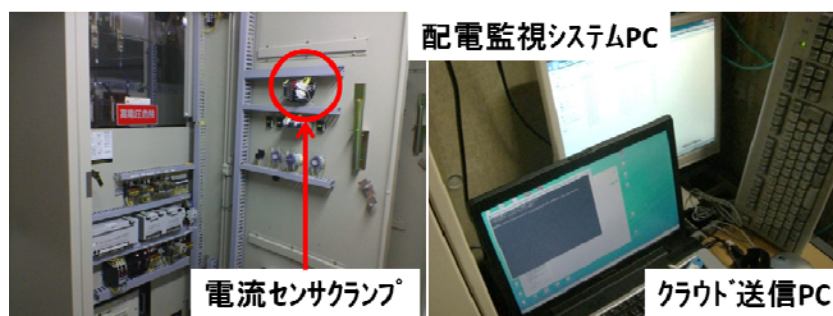
図2 電流センサと送信 PC の設置状況（K2 号館 B1F& 1F EPS 室）
